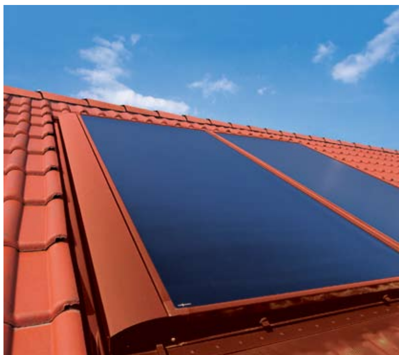
Fot. B.1.7-3 Integracja z dachem kolektora płaskiego
