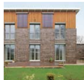
Fot. B.1.6–14 Kolektory próżniowe zamontowane na fasadzie budynku
