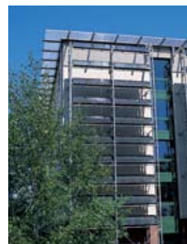
Fot. B.1.6–17 Kolektory płaski zamontowane na fasadzie budynku
